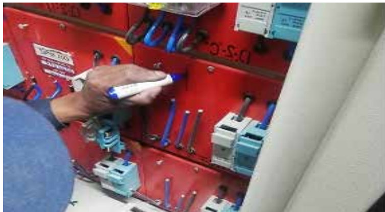
Figura 16 foto referencial de inst. eléctricas y medidor
