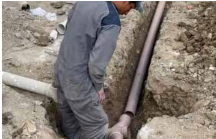
Figura 15 foto referencial de instalaciones sanitarias y desagüe sanitario
